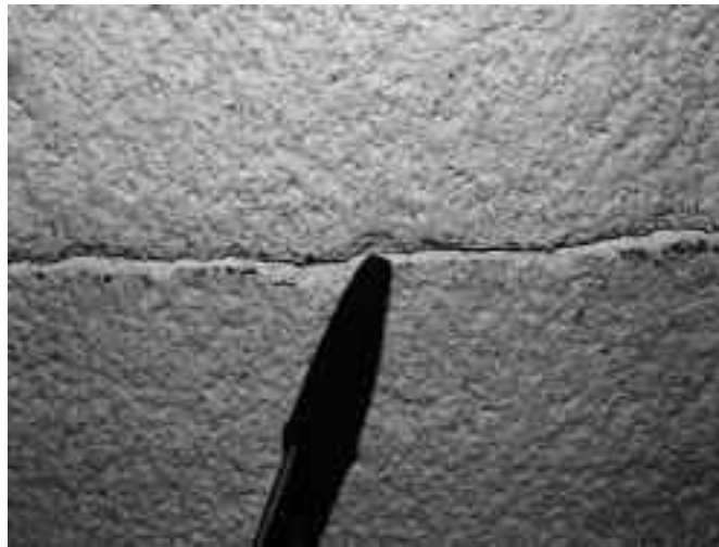
Fotografía n°5: Fisura simulada en mortero monocapa
